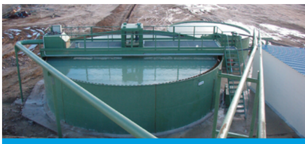
Decantador 8 m \varnothing con cuba de aguas claras 8 m \varnothing
